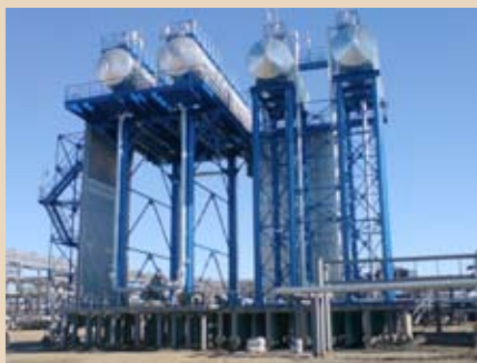
Рис. 2. ЦПСН Месторождение «Южное Хыльчугу», Несущие и опорные металлоконструкции – покрытие ЦИНОТАН+ПОЛИТОН-УР
